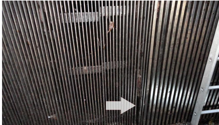
Figur 2: Vid arbetena i kraftverksintaget under augusti – september uppmärksammades och åtgärdades en glipa i fingallret (pilen). Henrik Jacobson 2012.
